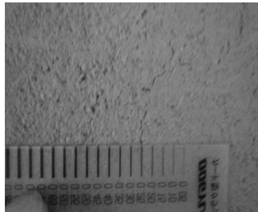
写真 22 ひび割れの発生状況(2)
