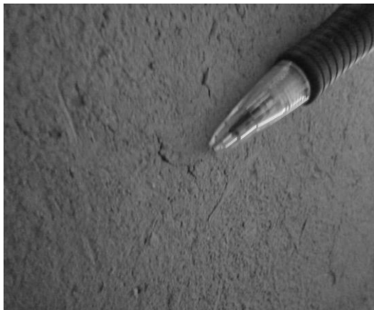
写真 21 ひび割れの発生状況(1)
