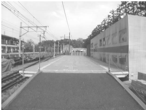
写真 6-24 模擬ホーム (スロープ側から)
