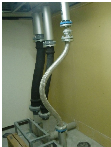
変位追従状況 (配管)
